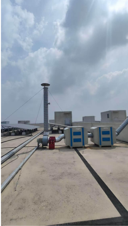
注液废气排气筒
