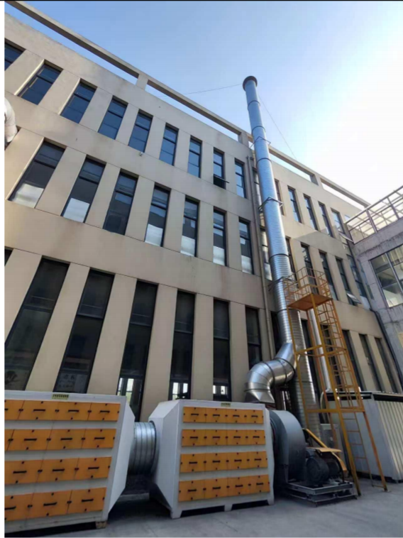
过滤棉+二级活性炭处理装置+25m 高排气筒（DA001）
