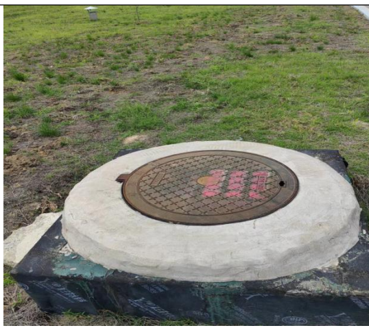
重金属废水应急池 300m 3
