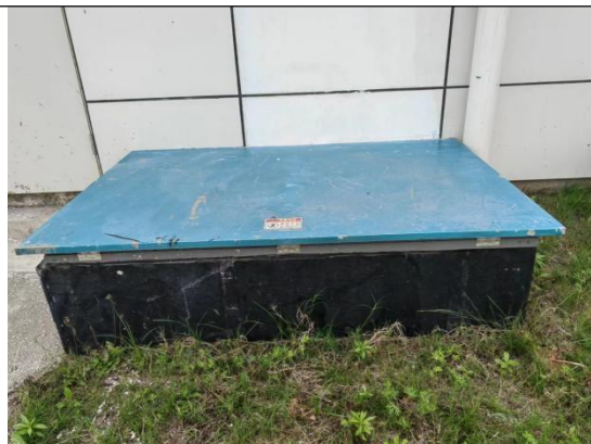
含镍废水应急池 252m 3
