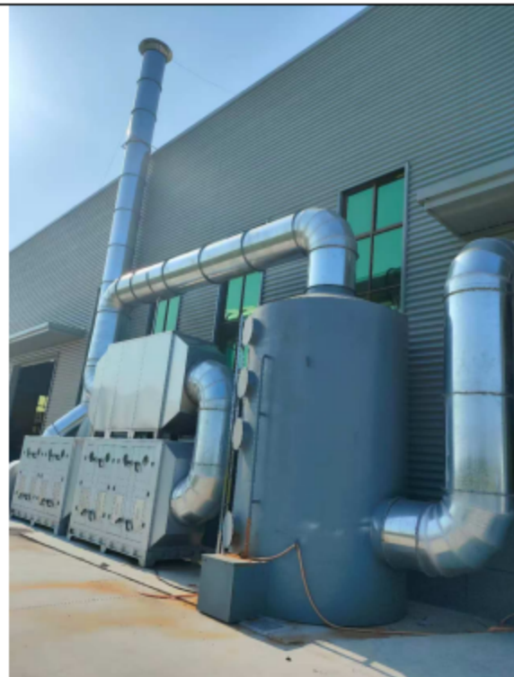
DA016环保措施和排气筒
