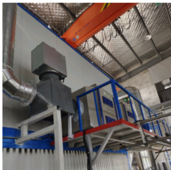
冷凝器+二级活性炭吸附装置
