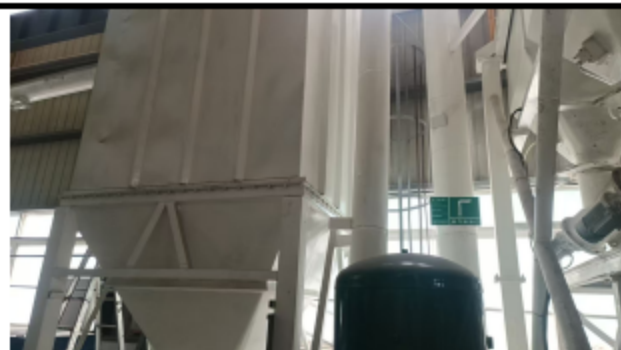
除尘设施及排气筒
