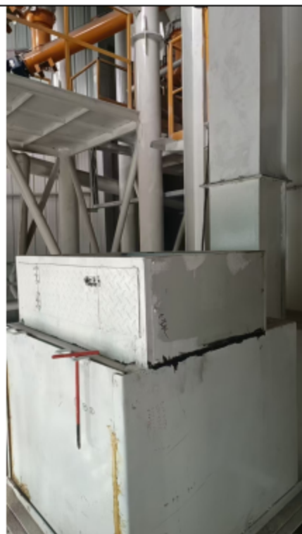
吨包投料口粉尘收集
