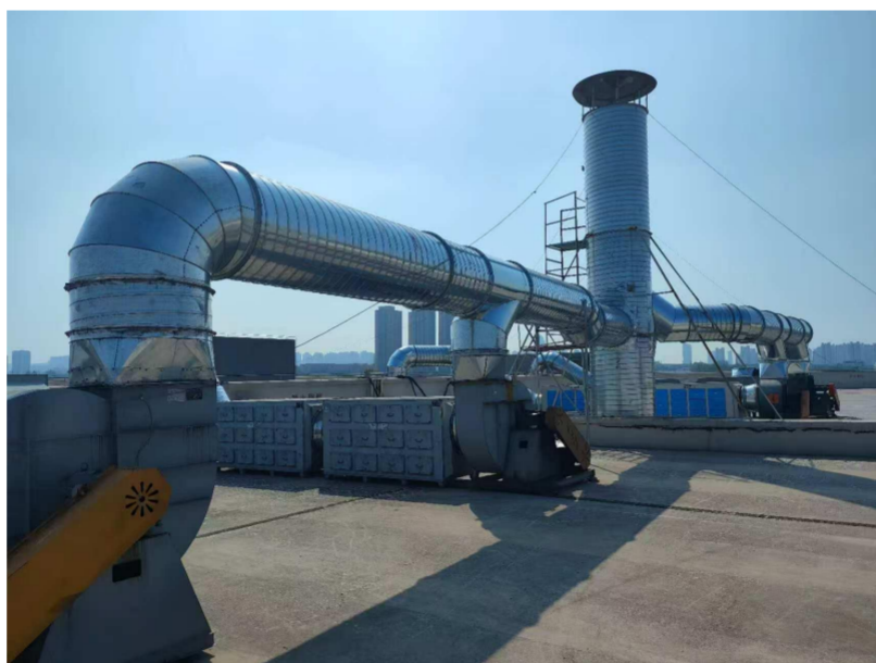
4 套过滤棉+二级活性炭处理装置+25m 高排气筒（DA001）
