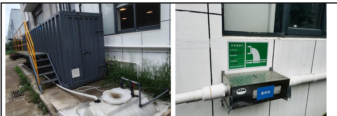
图3-3 污水站及废水排放口
